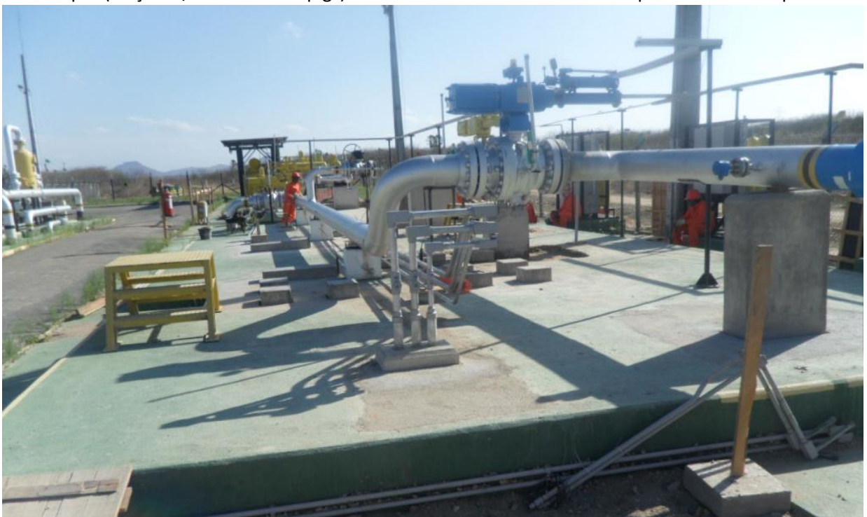
Montagem das válvulas XV's no LRP da Estação Termoceará, em Pecém, Ce
