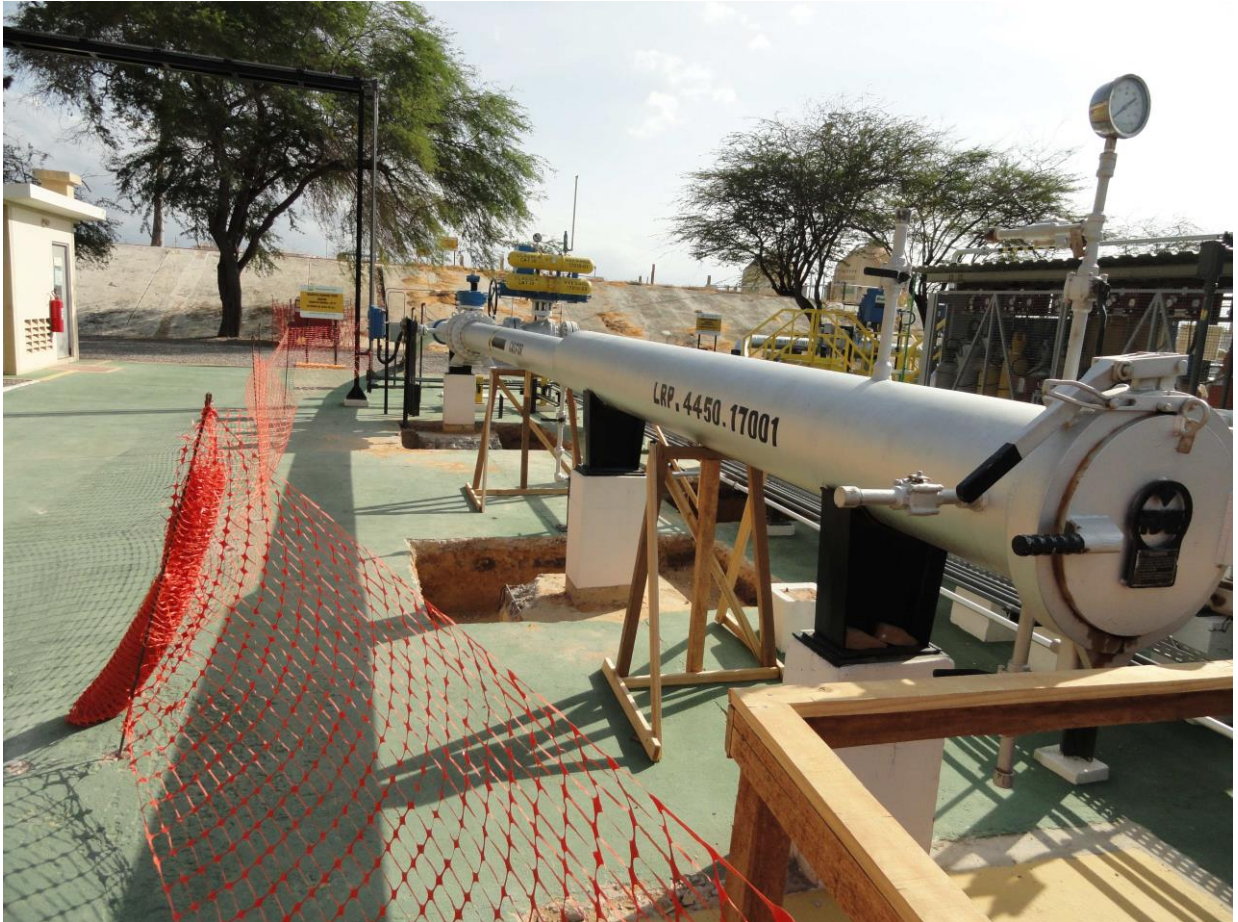
Um scraper (lançador/recebedor de pigs) instalado na base de Pecém. Os suportes foram adaptados
