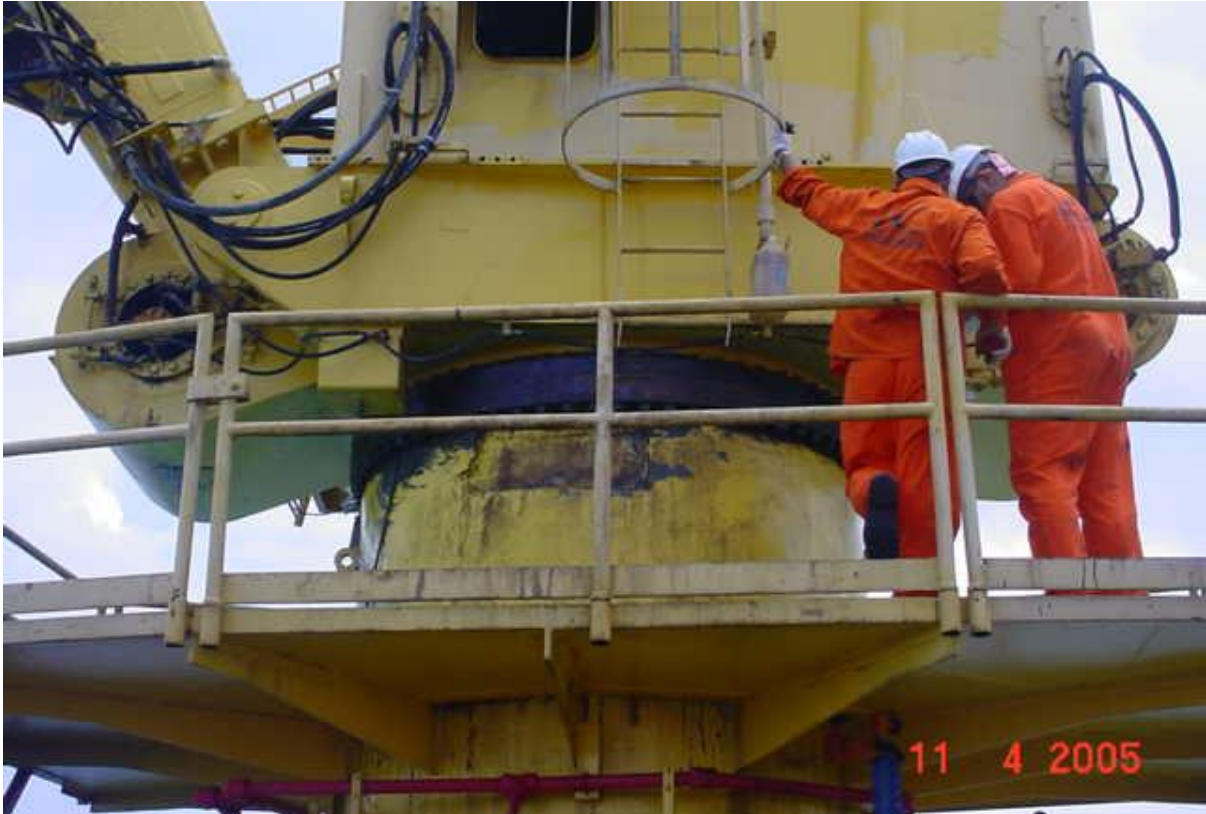
Coleta de dados para o projeto de troca da pista de giro do guindaste da plataforma PAT-3.
