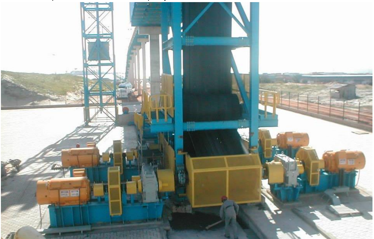
Sistema de tração da correia transportadora de carvão mineral em Pecém, CE
