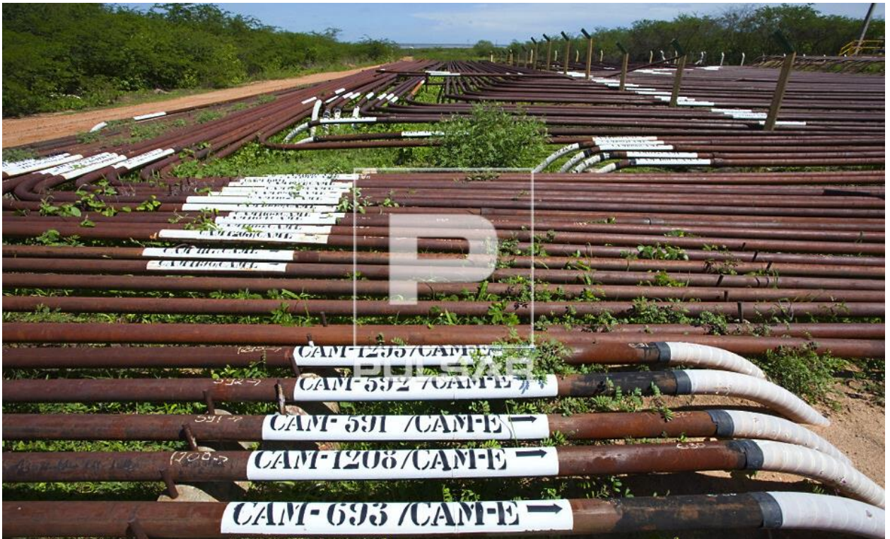
Projeto e planejamento do rearranjo e conexão às multivias, das linhas de produção dos poços em diversas estações coletoras no campo terrestre de Canto do Amaro (EC-CAM), na Bacia Potiguar.
