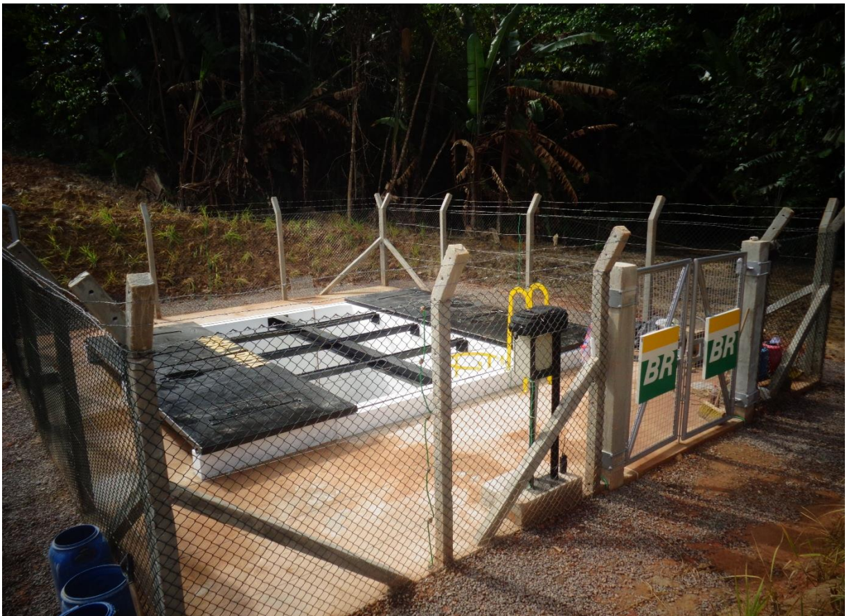
Caixa do provador de corrosão, parte do trecho substituído do gasoduto ORSOL, em Urucu, AM
