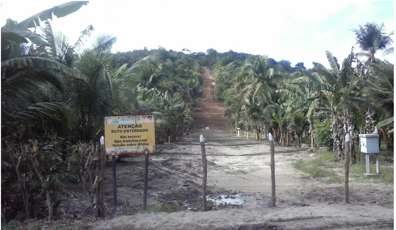
Faixa de domínio do gasoduto Nordestão em Igarassu, PE: uma das travessias de rios que teve o trecho do duto substituído
