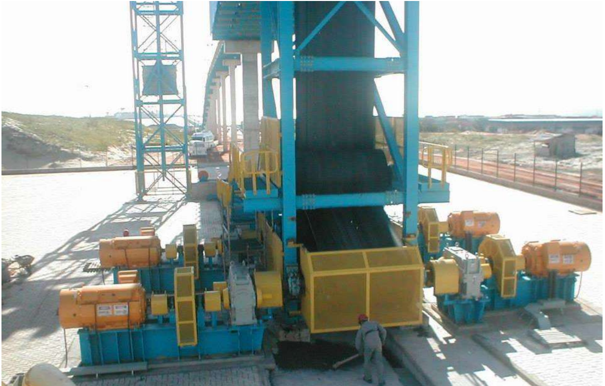
Sistema de tração da correia transportadora de carvão mineral em Pecém, CE. Construção KOCH Tecnometal.
