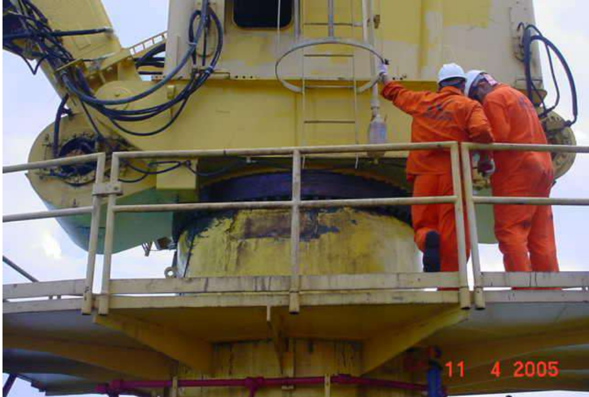
Coleta de dados para o projeto de troca da pista de giro do guindaste da plataforma PAT-3, pela ENGEMAN
