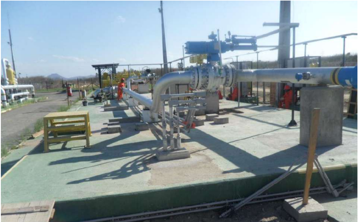
Montagem das válvulas XVs no LRP da Estação Termoceará, em Pecém, Ce. Construção pela GDK.
