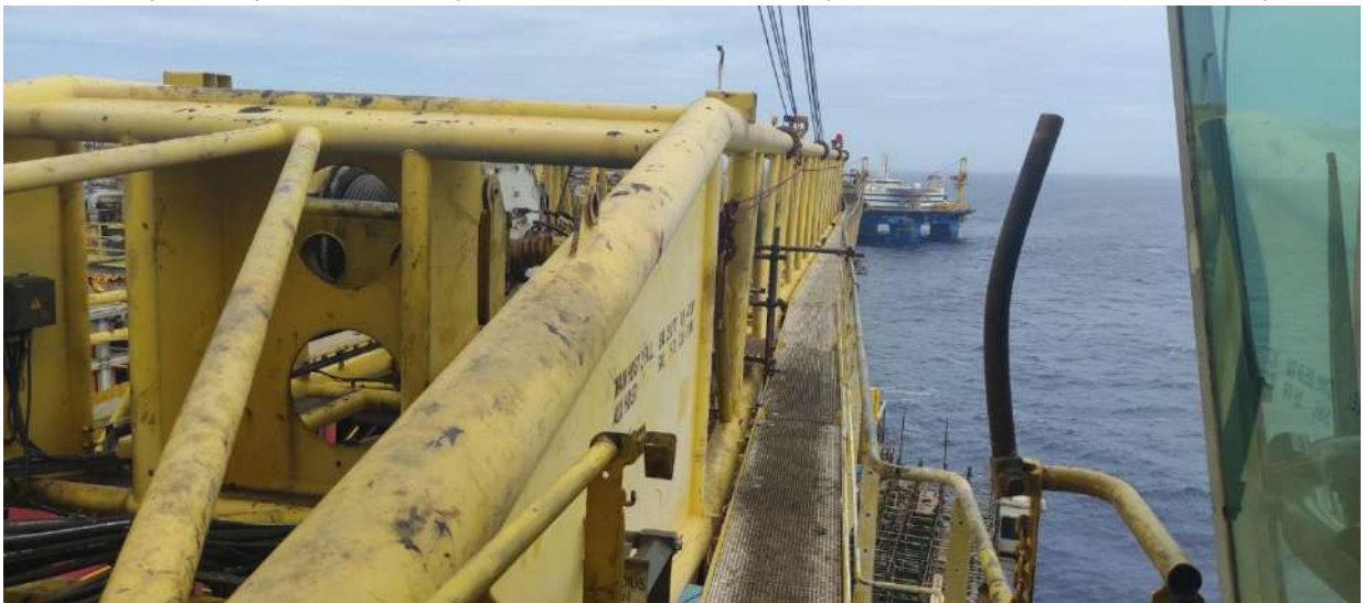
Lança do guindaste Liebherr da plataforma P-51, antes da instalação da linha de vida.
